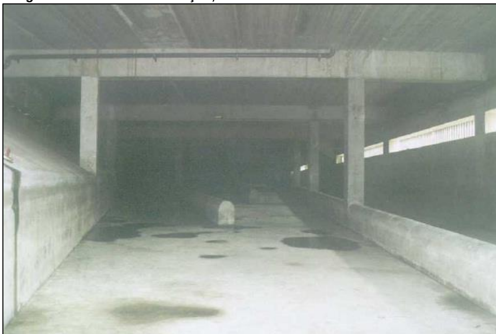
Figura 5.2 – Bacia de retenção, estrutura de armazenamento subterrânea.
