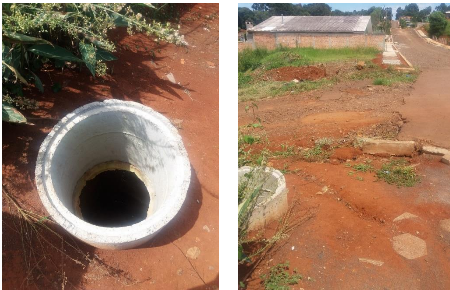
Figura 47: Poço de visita na Rua Padre Valentim Nogli
