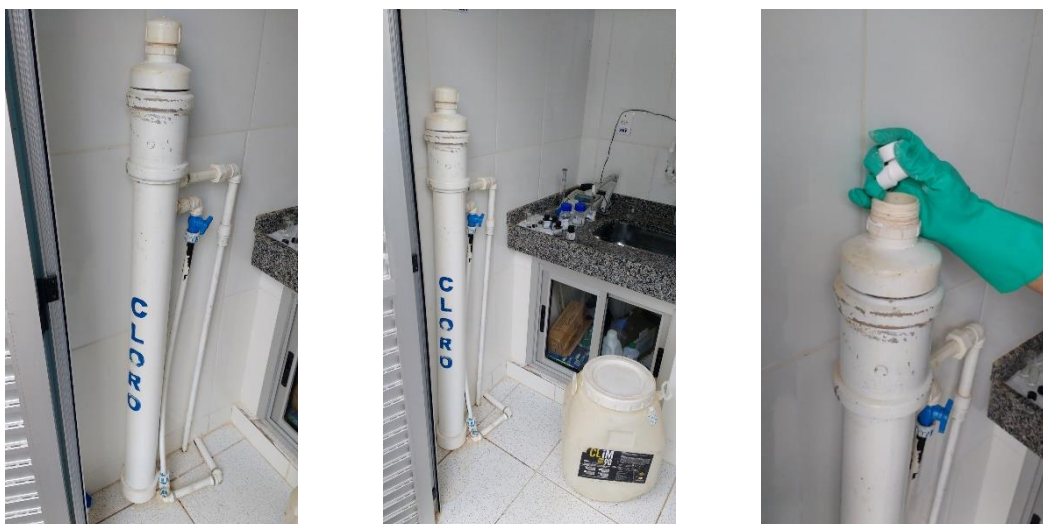
Figura 21: Saturador de cloro usado para o tratamento de água
