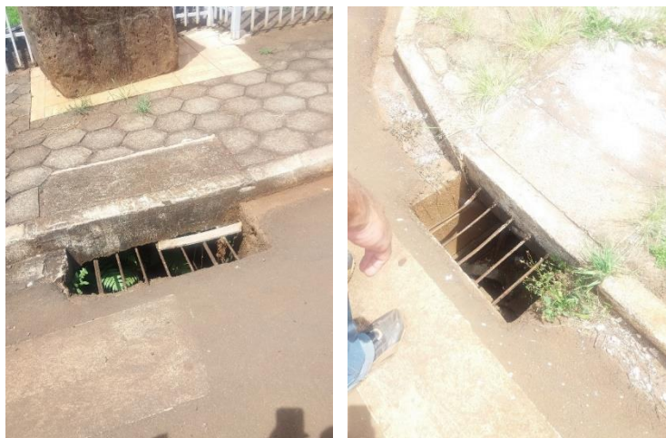
Figura 49: Bueiros em Campina do Simão
