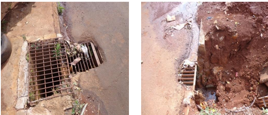
Figura 48: Bueiros em Campina do Simão
